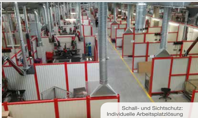
Hallenluftreinigung: Perfect air (Schichtlüftung)
